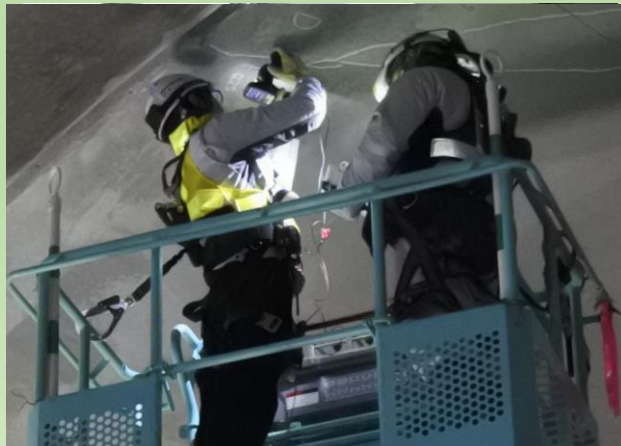
トンネルひび割れ調査例
